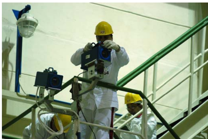
FIG. 2. Montaje de equipo de vigilancia en una instalación nuclear.
