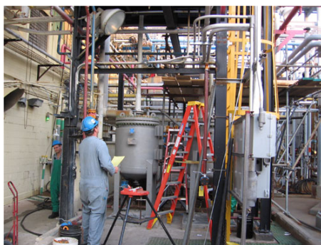
РИС. А-10. Новый испаритель фтористого водорода на заводе "Метрополис уоркс" фирмы "Ханиуэлл", шт. Иллинойс, США (фото: Coverdyn).
