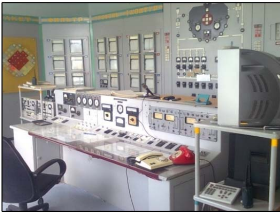
UZB9005. Изготовленные в 60-е годы прошлого века приборы контроля и управления, которые были заменены современным оборудованием.
