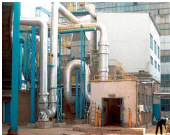
FIG. 1 .Planta experimental para el tratamiento de gases de combustión por haces de electrones en la central termoeléctrica de Maritsa Este II de Bulgaria.
